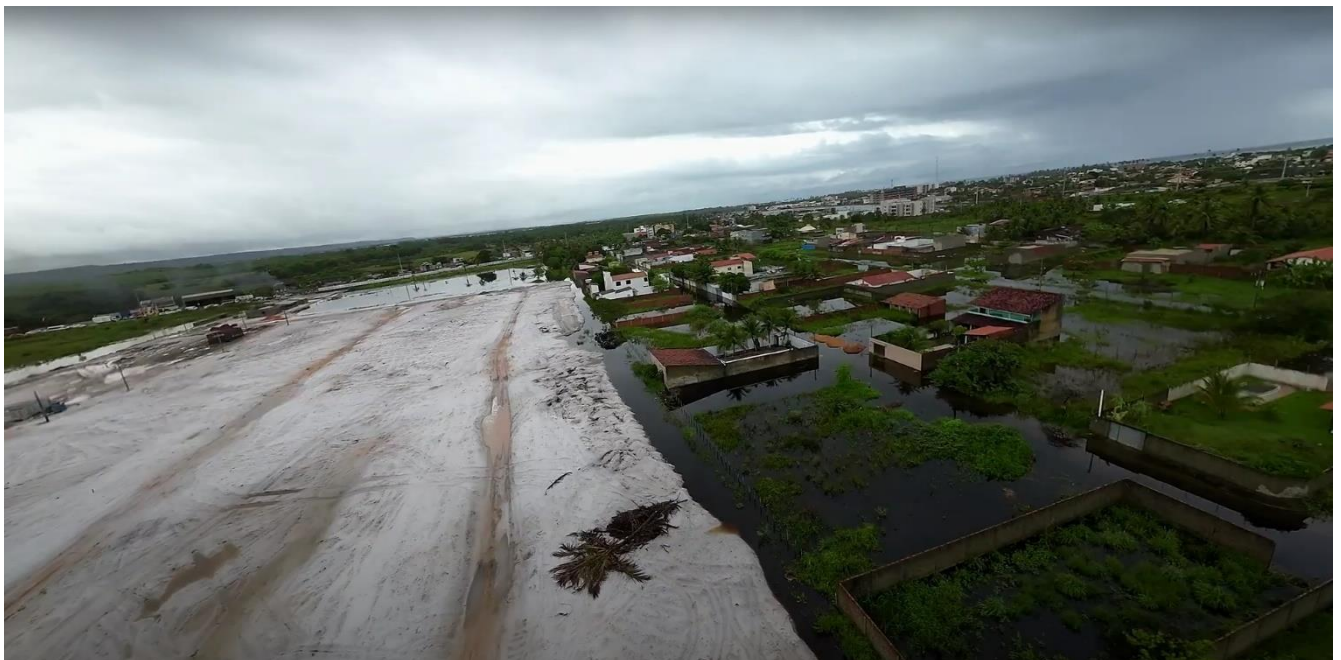
Marechal Deodoro/AL: Loteamento em construção. As ruas estão inundadas, sem ter o devido escoamento. (maio, 2024).
